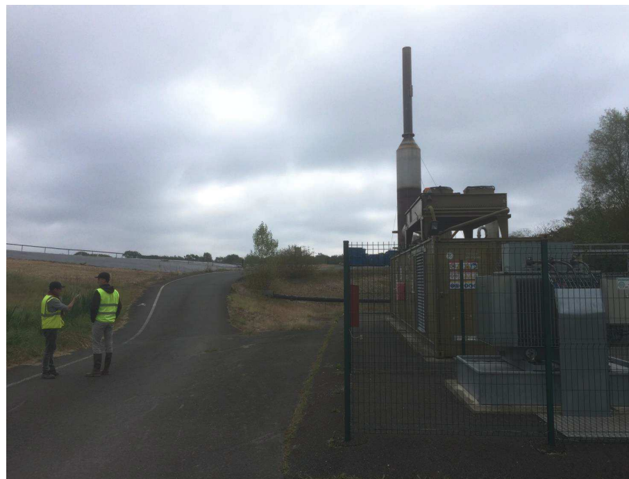
Photo 3 : Installation de valorisation du biogaz sur le site de l'ISDND de Villeheritiers
