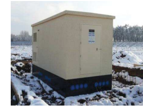
Exemple de poste de livraison
